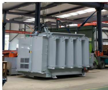
图 1 火电厂变压器设备
